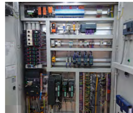
Steuerung für Absaugung
