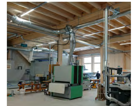
Absaugleitungen und Rückluft
