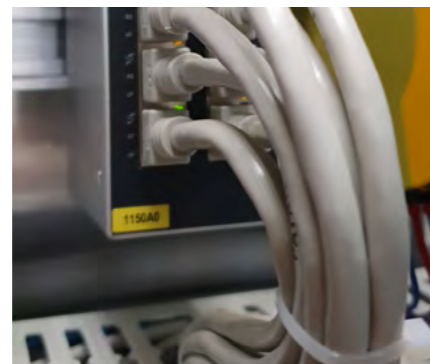
Steuerschrank mit Ethernet Steckdose
